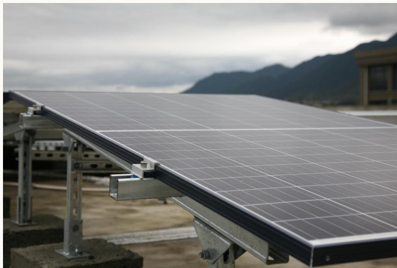
Sistema fotovoltaico planta de producción MADODO XXI SAS BIC
