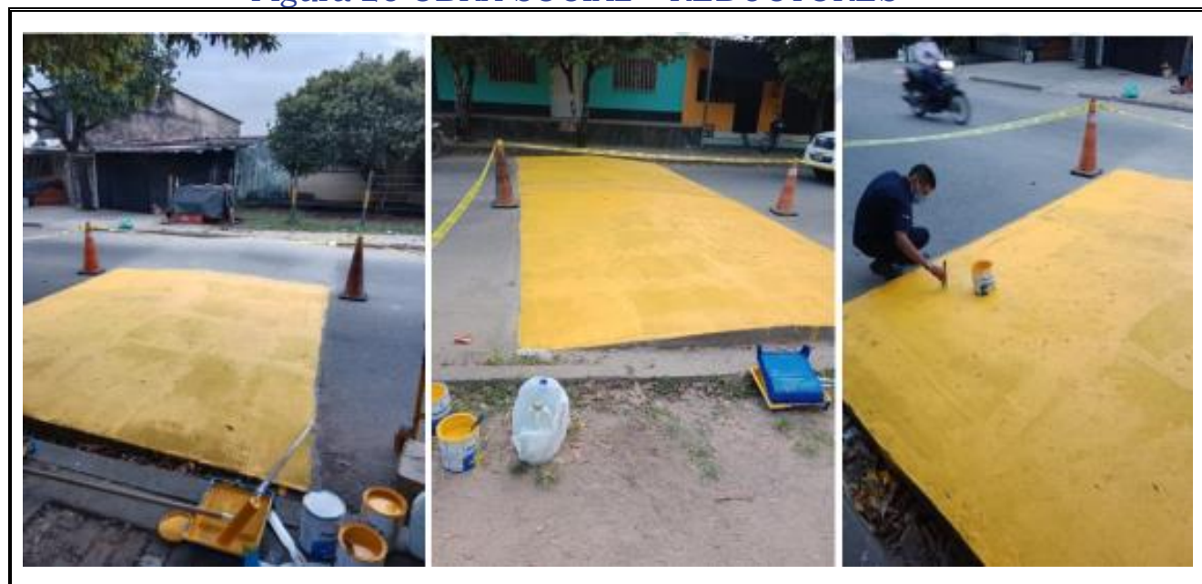
Figura 26 OBRA SOCIAL – REDUCTORES
